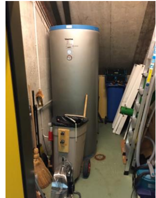
Elektrische Wassererwärmer im 1 Untergeschoss
