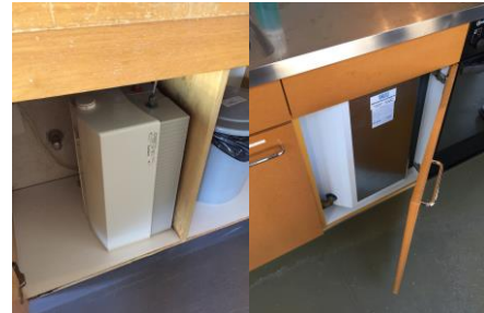
Zwei Bsp für elektrische Wassererwärmer in Küchen
