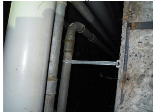
Versorgungsleitungen in Installationsschacht
