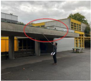
Korrosion, Abplatzungen, Armierung freiliegend (Vordach Eingänge)
