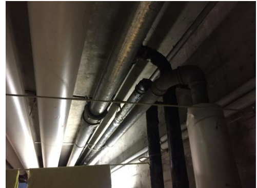
Leitungsführung im Gang im 2 Untergeschoss
