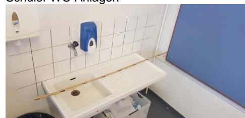
Waschrinnen in Klassenzimmer mit Kaltwasseranschluss
