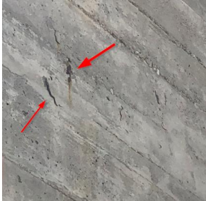
Korrosion sichtbar, kommende Abplatzung (div. Stellen)
