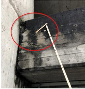
Kommende Abplatzung (Betondecke über Veloraum)
