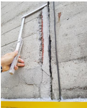
Alte Betonreparatur platzt wieder ab (Betonwand bei Lehrerterrasse)
